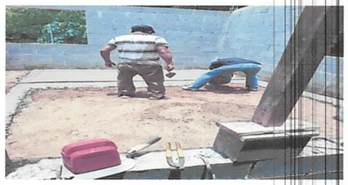
Foto 4: Torta de cemento dentro de la cocina.
